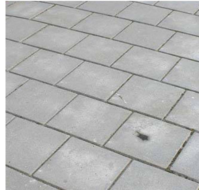
Trottoir van betontegels 30x30 met bijpassende kleur banden - biobased optie wordt bekeken
